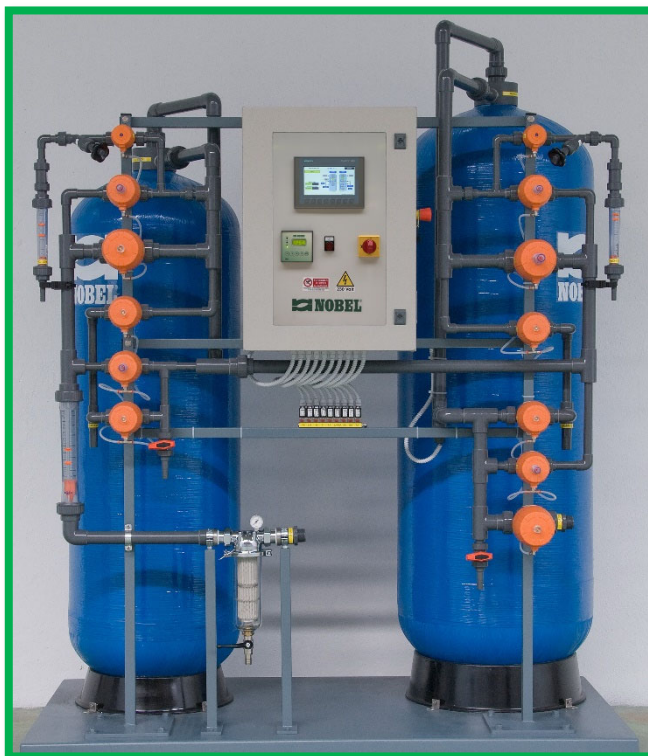
modello DAV50 con filtro FTA installato a bordo skid
